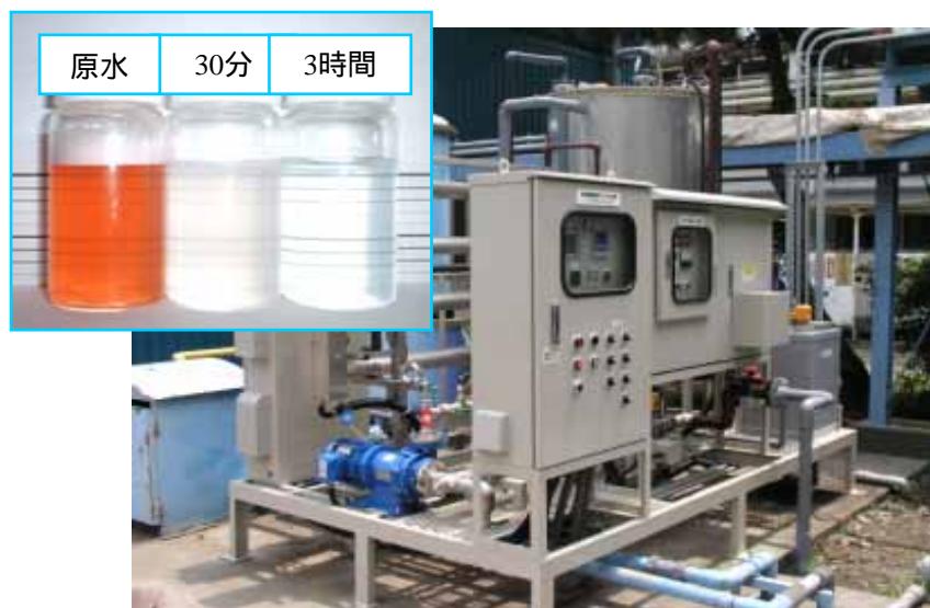
促進酸化 廃水処理装置
