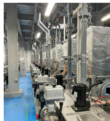
固液分離工程 (遠心分離機)
